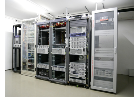
Rechenzentrum der CCF früher
